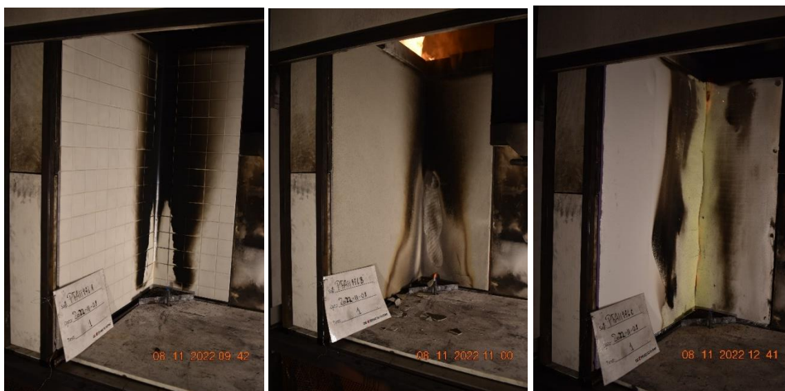
Figur 7: Prøveemner efter brandtest (tv. prøveemne A, mf. prøveemne B, th. prøveemne C)
