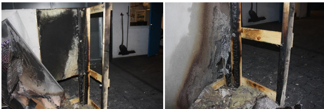
Figur 9: Prøveemne B (tv. prøveemne efter brandtest, th. skader på træreglar/substrate)
